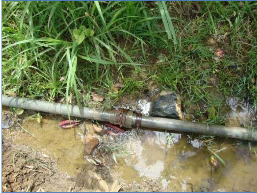
Figura 10. Vazamento na tubulação nas proximidades do hidrante.
