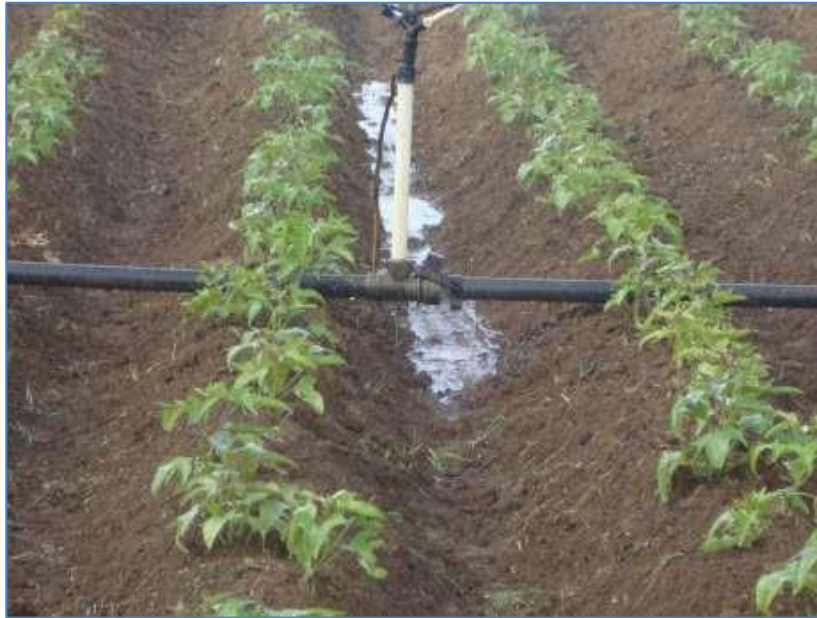
Figura 8. Vazamento próximo ao aspersor comprometendo o seu funcionamento, diminuição da vazão.
