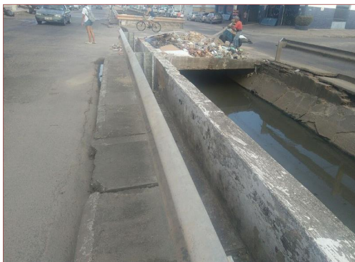
Figura 5: Drenagem no bairro Centro
