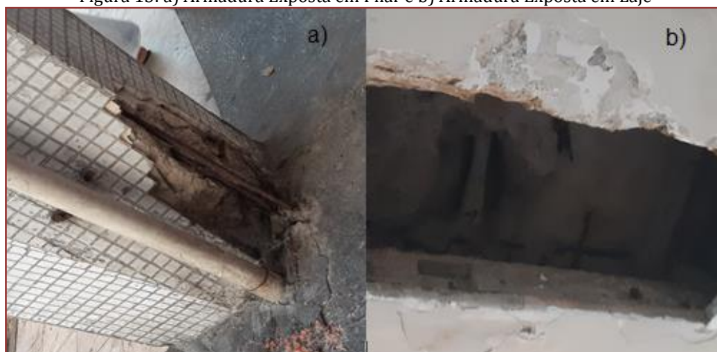
Figura 13: a) Armadura Exposta em Pilar e b) Armadura Exposta em Laje
