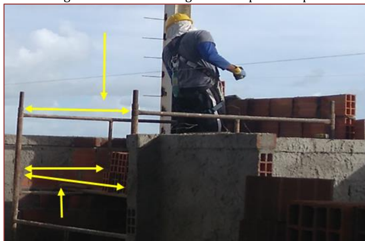
Figura3: Andaime sem guarda-corpo e rodapé.
