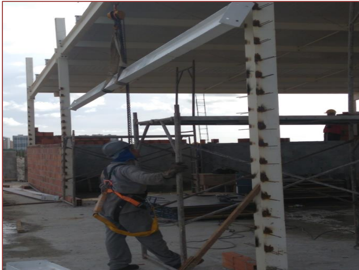
Figura 2: Mostra exposição de trabalhador ao risco de queda de material.
