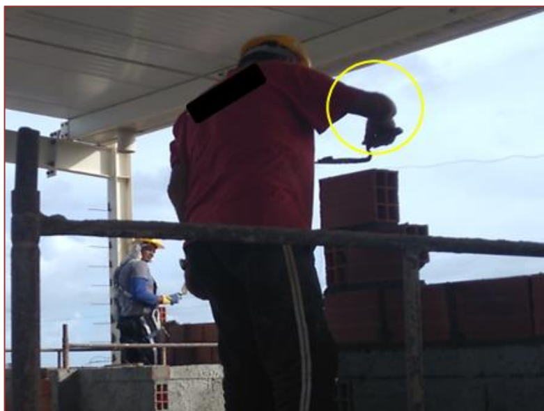
Figura 5: Trabalhador manipulando cimento sem uso de luvas.
