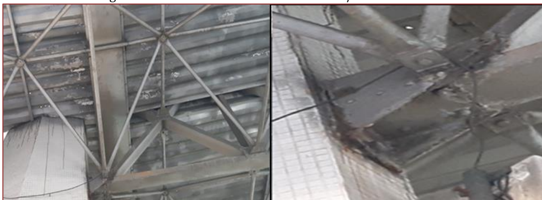
Figuras 10 e 11: Perca da Camada Pictórica / Vista da Corrosão
