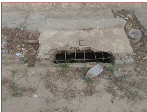
Figura 9: Estrutura da boca de lobo no bairro Cidade Nova
