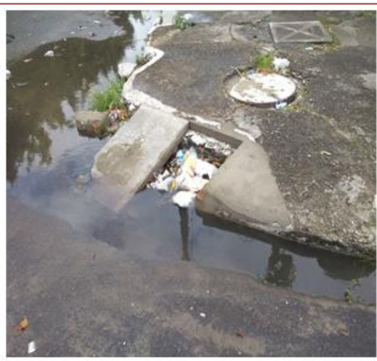
Figura 17: Resíduos sólidos na rede de drenagem no bairro Novo Paraíso.
