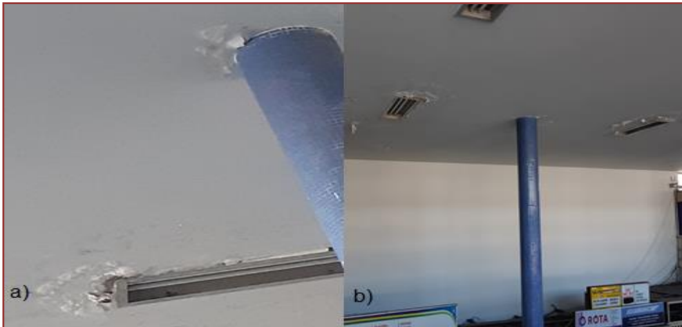
Figura 18: a) Infiltração Vista Próxima e b) Vista de Longe
