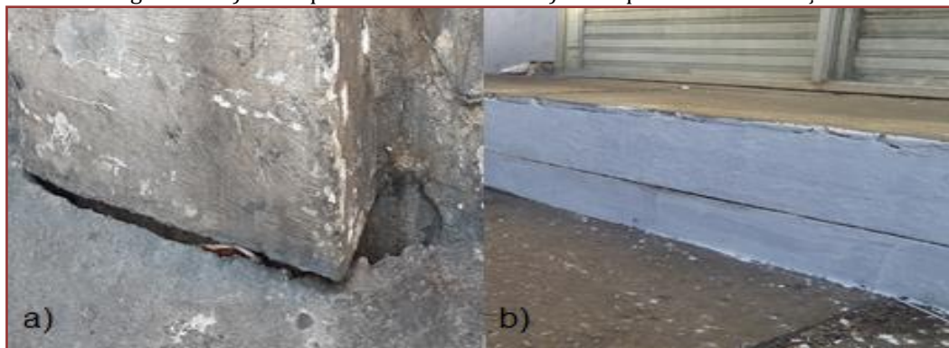
Figura 12: a) Recalque do Solo em Pilar e b) Recalque do Solo na Calçada
