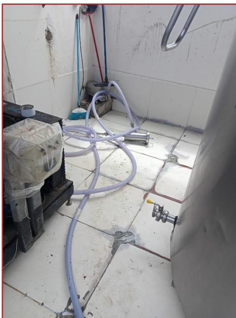
Figura 7: Condições das paredes e dos pisos da fabriqueta
