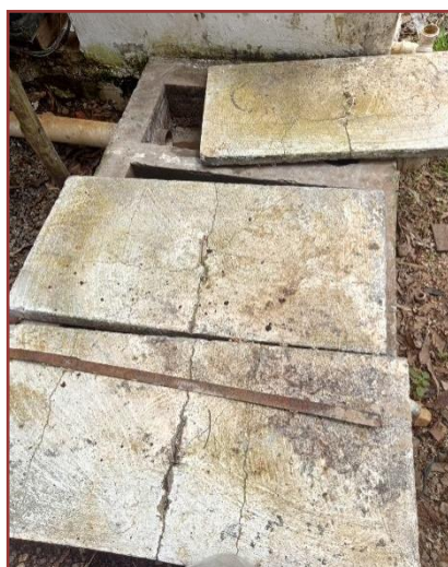
Figura 6: Caixas de drenagem de resíduo orgânico
