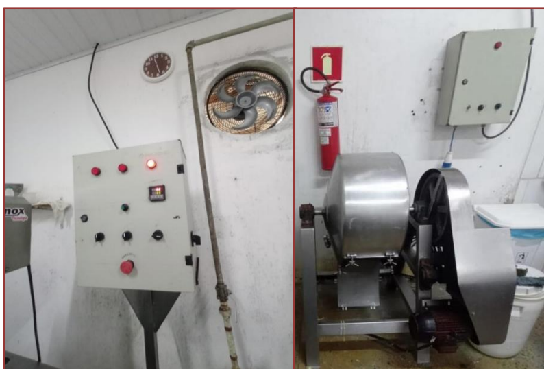
Figura 10: Quadro de força da parte elétrica da fabriqueta de queijo
