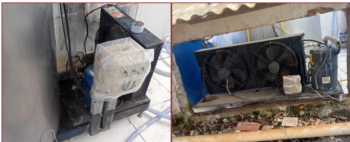
Figura 9: Motores elétricos para refrigeração do leite (9a) espaço interno (9b) espaço externo
