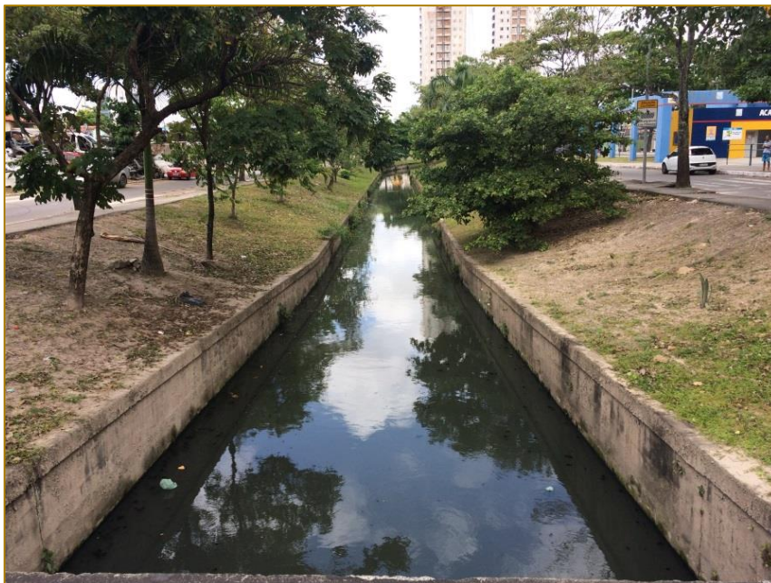
Figura 02: Estrutura de canal e talude com vegetação no riacho do Cavouco no bairro do Cordeiro, Recife-PE.
