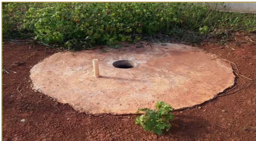
Figura 4 – Cavidade subterrânea para armazenamento temporário de dejetos
