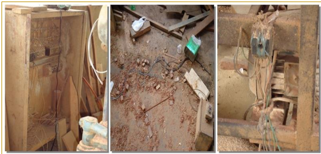
Figura 03 – Instalações elétricas na movelaria
