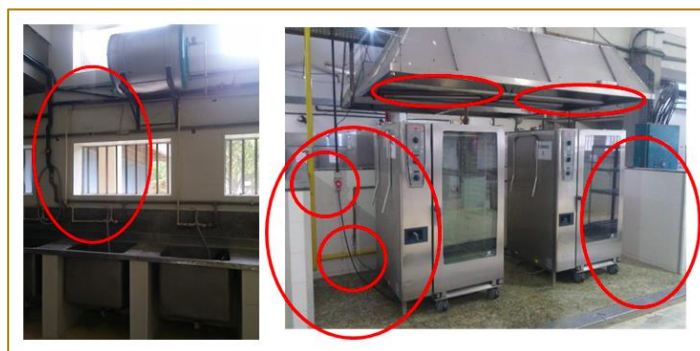
Figura 2 - Boiler do sistema de aquecimento de água (B) e Fornos a gás (Fs).
